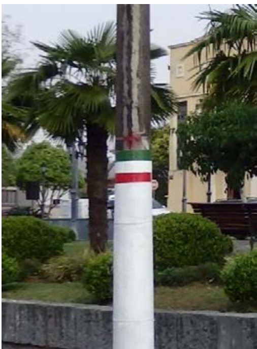
Fig.27: Poste de rede: apropriação. Fonte: Autor, 2017.
