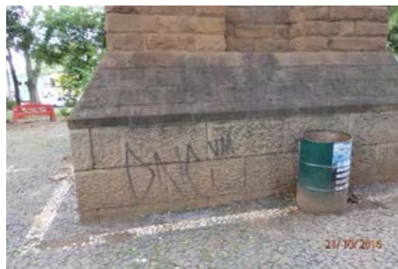
Fig.49: Base do monumento pichada e lixeira. Fonte:Autor, 2016.
