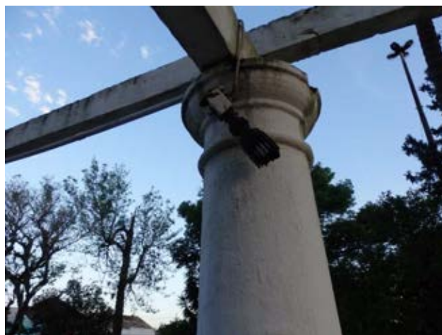
Fig.38: Pergolado com ligação de energia. Fonte: Autor, 2019.
