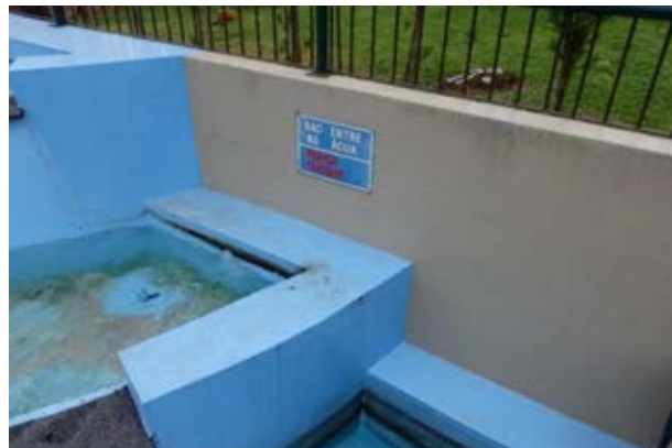
Fig. 15: Detalhe do chafariz e placa de alerta para choque. Fonte: Autor, 2016.
