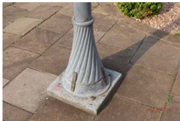
Fig.30: Poste de iluminação: adaptado para retirada em eventos. Fonte: Autor, 2017.
