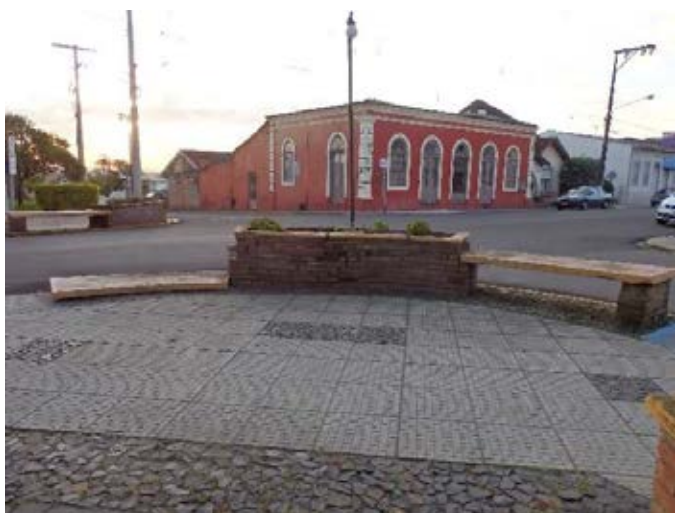
Fig.39: Banco colapsado. Fonte: Autor, 2019.
