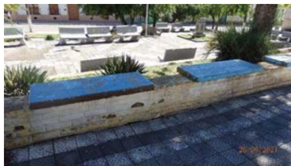
Fig.67: Degradação na pintura. Fonte: Autor, 2021.
