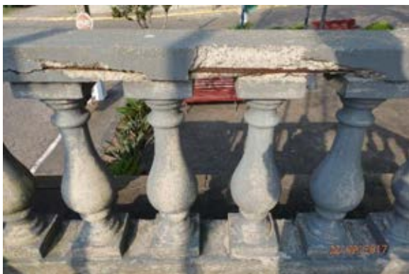
Fig.29: Balaustrada do coreto sobre os banheiros. Ferragem aparente. Fonte: Autor, 2017.
