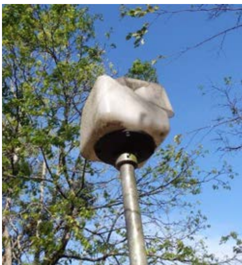
Fig.23: Cúpula luminária quebrada. Fonte: Autor, 2016.
