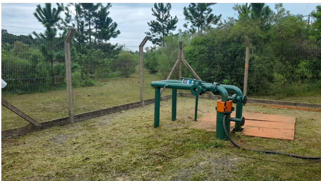
Figura 9. Poços de captação de água - Cervejaria Águas Claras do Sul
