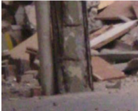
Figura 3 - Fotografia referente à inspeção do Edifício Santa Fé após o sinistro.
