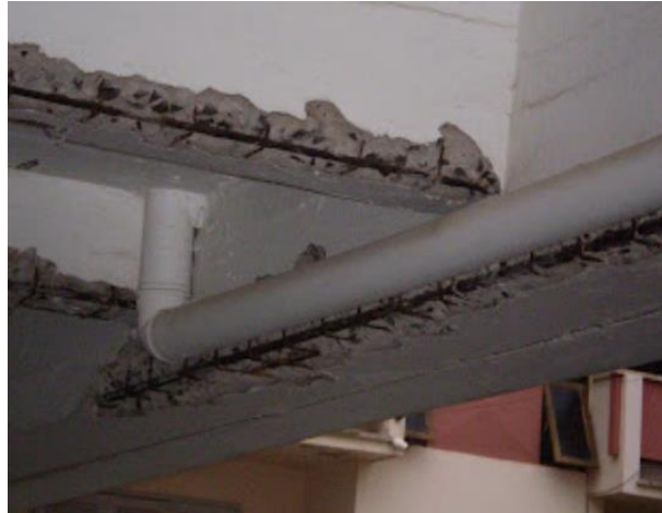
Figura 2 - Fotografia referente à inspeção do Edifício Santa Fé após o sinistro.
