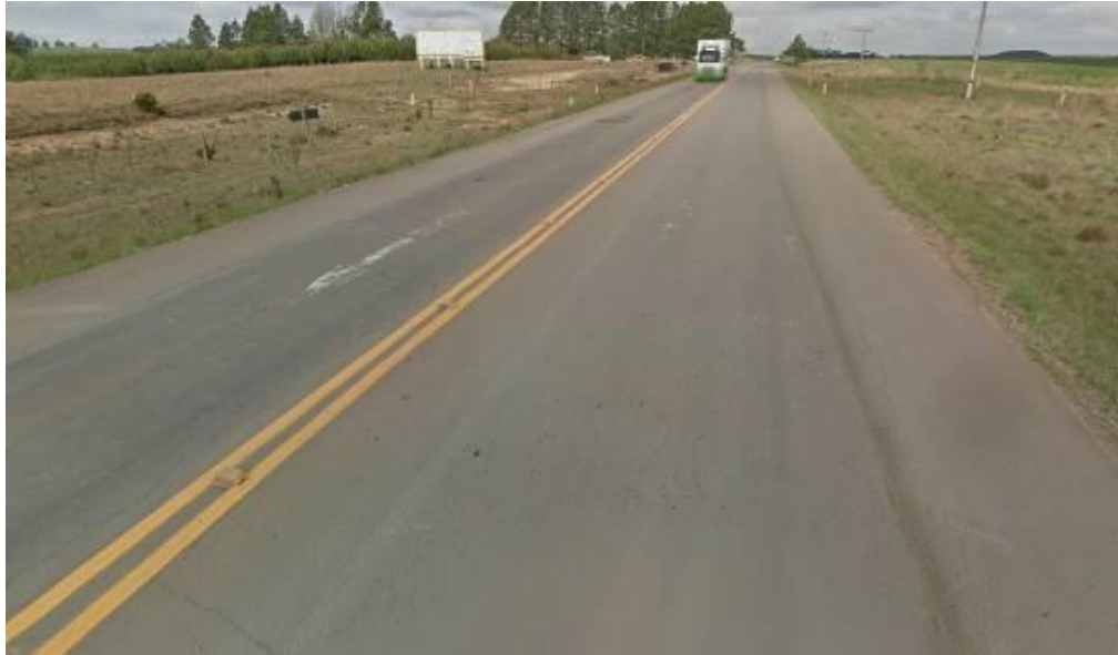
Figura 38 – Condições da pista de asfalto na região dos testes.
