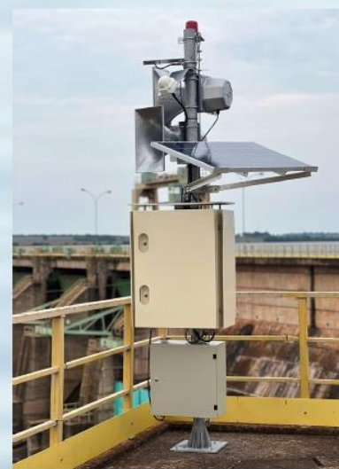
ESTAÇÃO DE SIRENES
