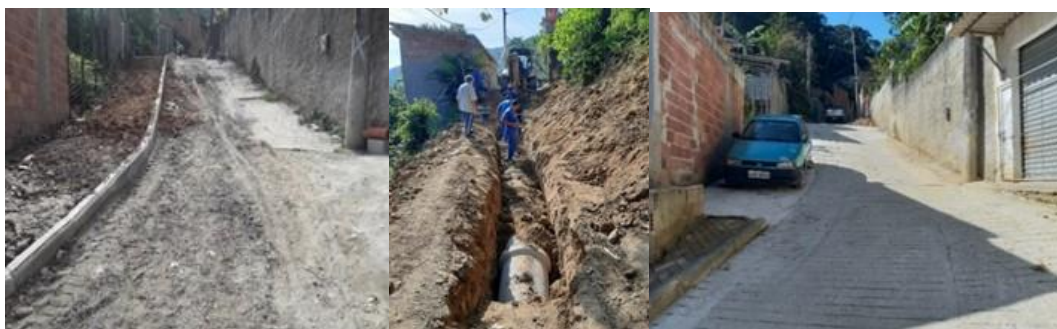
Figura 3. -Fotos das obras da comunidade do Vale Verde mostrando o antes, durante as obras de drenagem e o depois com a drenagem e a pavimentação concluídas.
