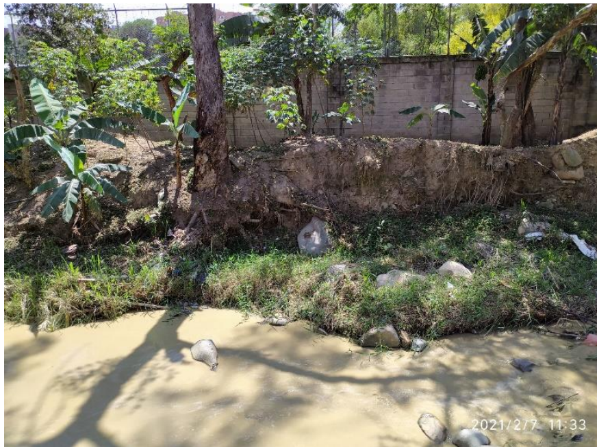
Figura 8. Erosión y raíces expuestas en los puntos críticos 11, 12 y 13
