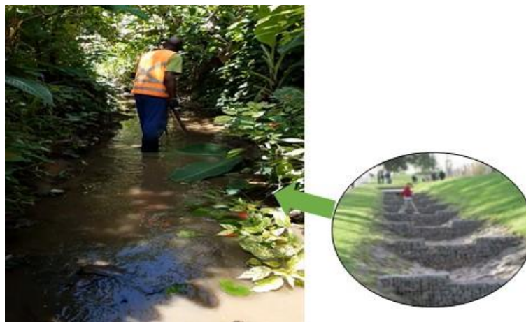
Figura 11.- Imagens ilustrativas de solução proposta – inserção de degrau de nível para aumento da biodiversidade.
