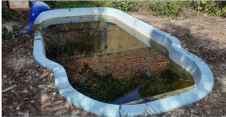
Figura 14. Piscina sem manutenção
