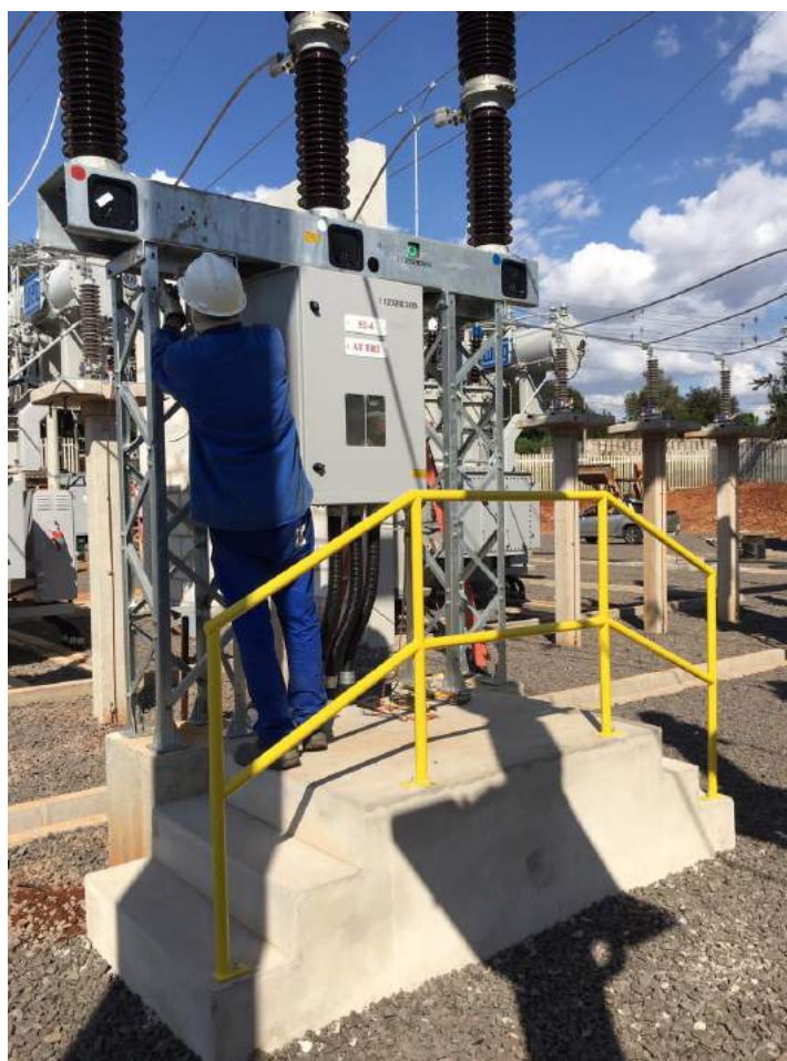
Figura 9 - DJ 69 kV de Tanque Vivo
