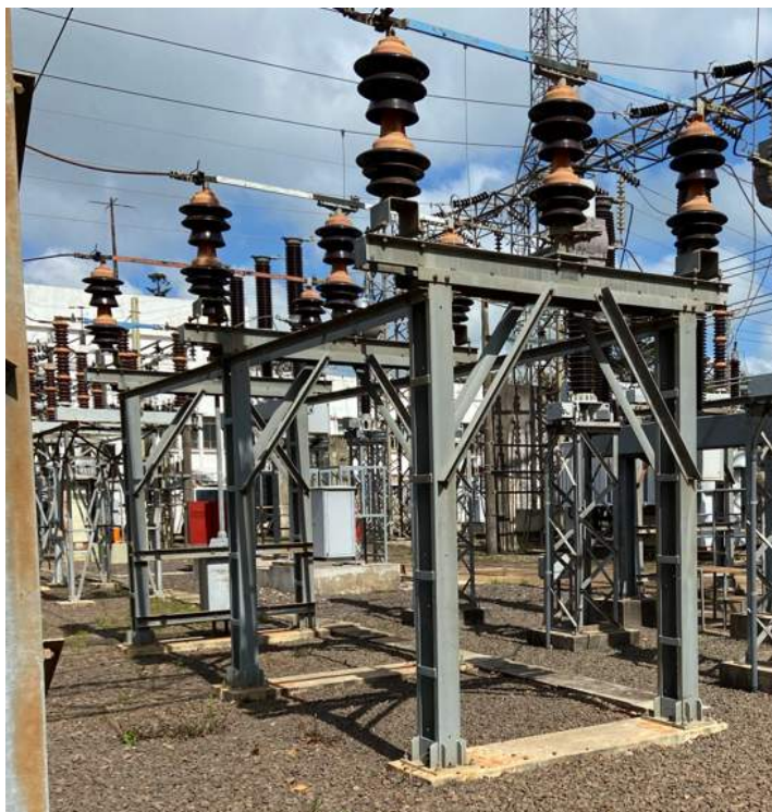
Figura 24 - Seccionadora 138 kV em estrutura perfilada
