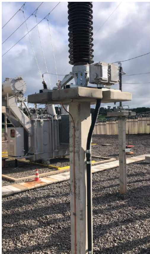
Figura 23 - Transformador de Potencial 69 kV em capitel de concreto
