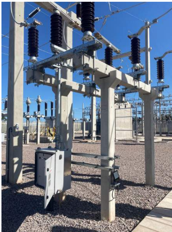
Figura 8 - Seccionadora DAL 69 kV comando motorizado sem lâmina de terra
