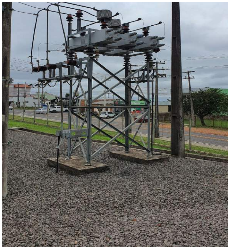
Figura 10 - Banco de Capacitores 23 kV
