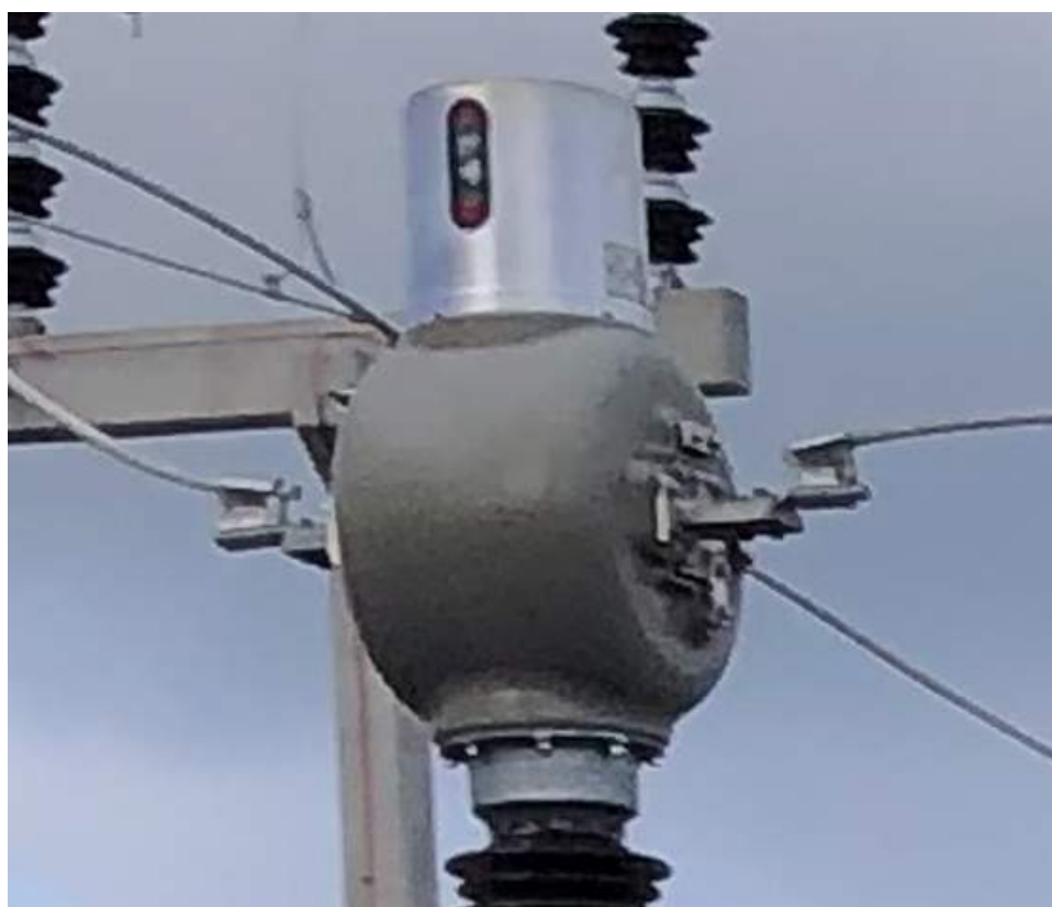
Figura 17 - Conexão de rede aérea de um TC de 69 kV
