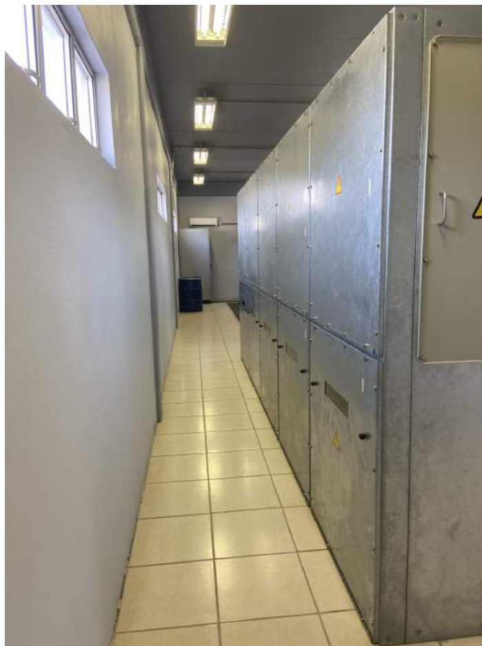
Figura 3 - Exemplo de subestação abrigada
