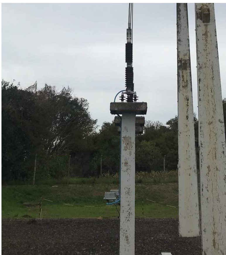
Figura 4 - Pára-raios ZnO 69 kV
