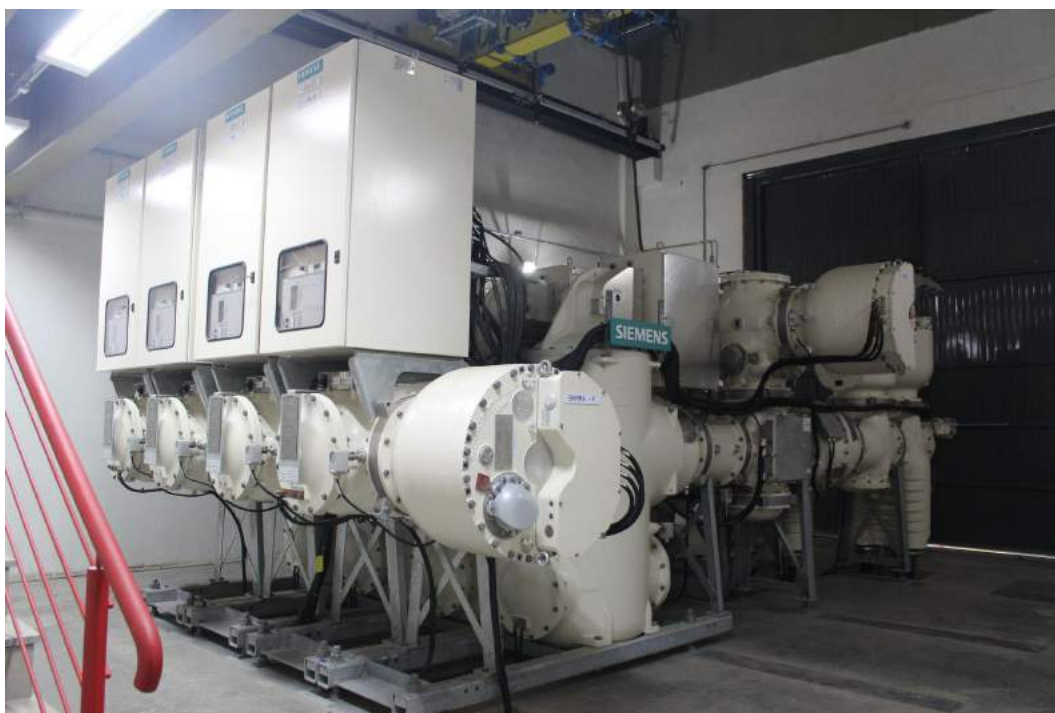
Figura 2 - SE Menino Deus; exemplo de subestação GIS
