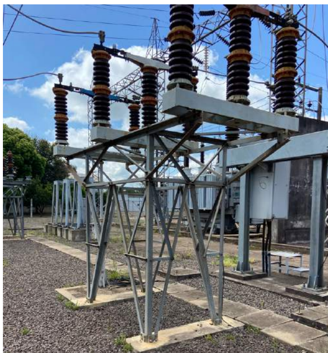
Figura 25 - Seccionadora 69 kV em estrutura treliçada
