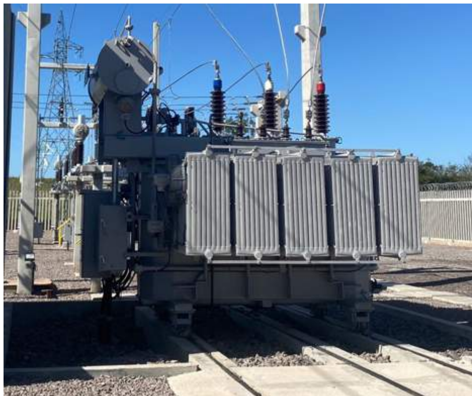
Figura 11 - TF 69-13,8 kV 12,5 MVA em bacia coletora de óleo
