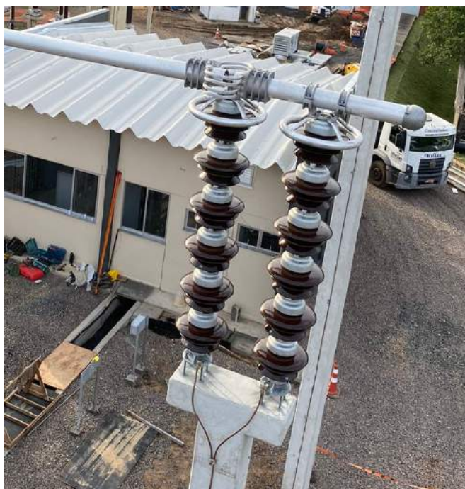
Figura 13 - Suporte de barramento rígido 230 kV
