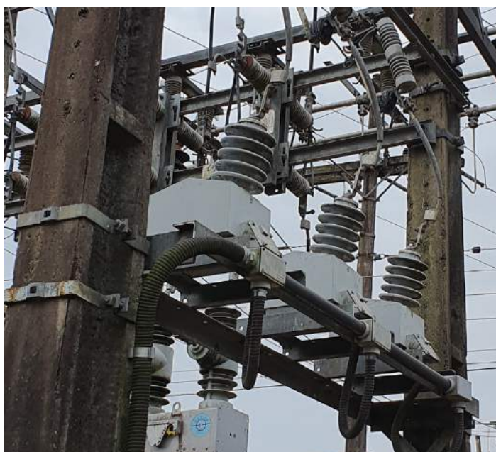
Figura 7 - TP de 23,8 kV e placa de identificação
