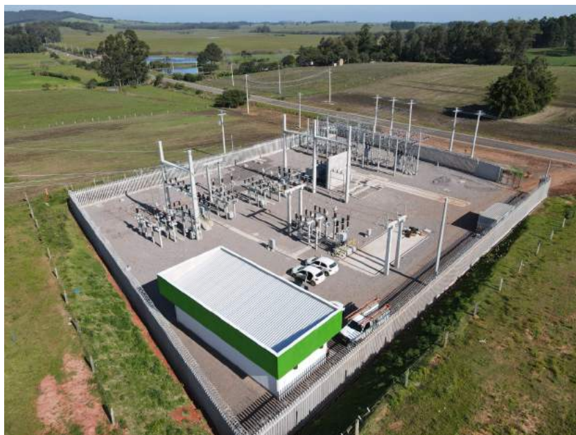
Figura 1 - SE CERTAJA 3; exemplo de subestação AIS
