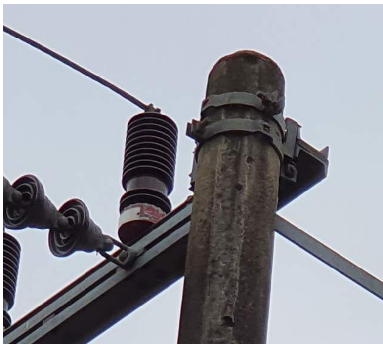
Figura 5 - Pára-raios ZnO 23 kV
