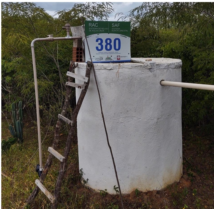
Figura 32 - Tanque de armazenamento de água do RAC
