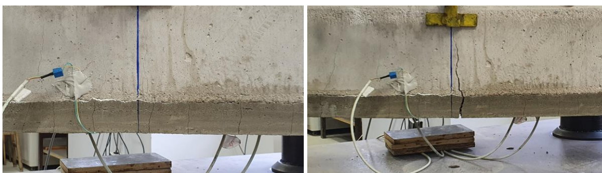
Figura 127 – Formação de fissuras (a) e de abertura da fissura central (b) (Fonte: Autor)
