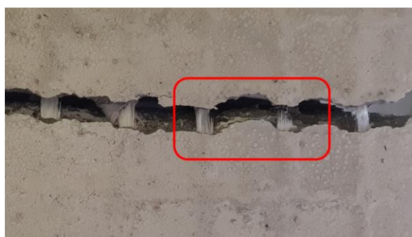
Figura 129 – Ruptura das fibras na viga V14 (Fonte: Autor)
