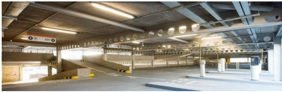
Figura 1.7 - Viga alveolar mista em edifício garagem (MCLAUGHLIN; HARVEY, 2017)
