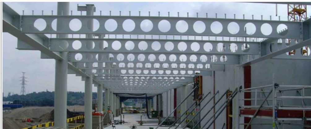
Figura 1.6 - Viga alveolar com conectores de cisalhamento à espera da concretagem da laje (CONSTRUCTALIA, 2008)
