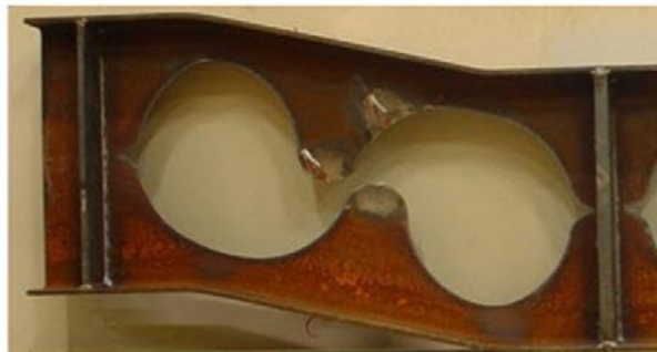
Figura 2.8 – Ruptura na região da solda em viga celular (TSAVDARIDIS; D'MELLO, 2011)
