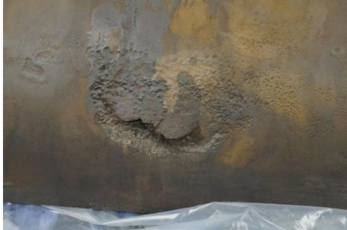
Figura 6 - Corrosão externa que causou o rompimento do duto em Santa Bárbara
