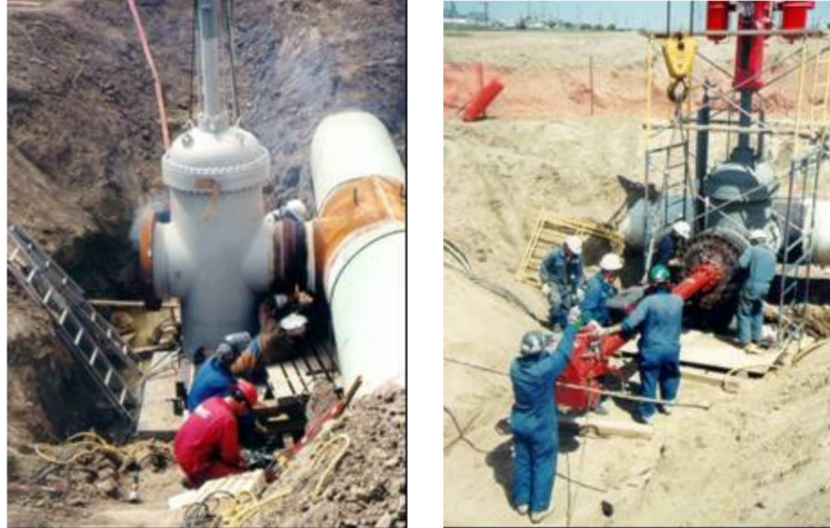
Figura 13 - Método de reparo Hot Tapping
