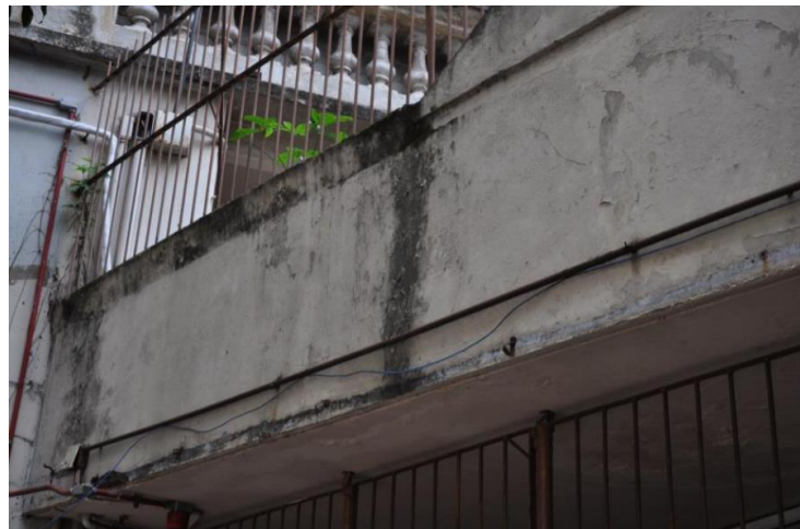
Figura 1 – Sujidade e manchamentos em prédio histórico no campus central da UFRGS
