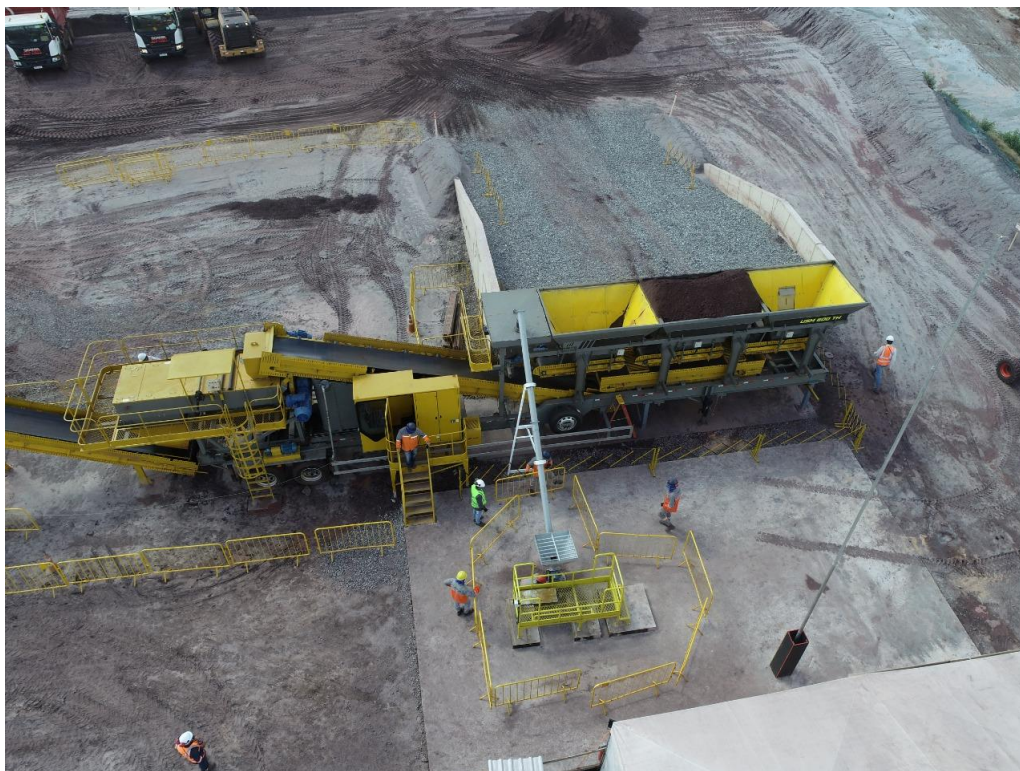
Figura 3.15 – Imagem da usina de mistura e dosagem de solos utilizado na construção da pilha
