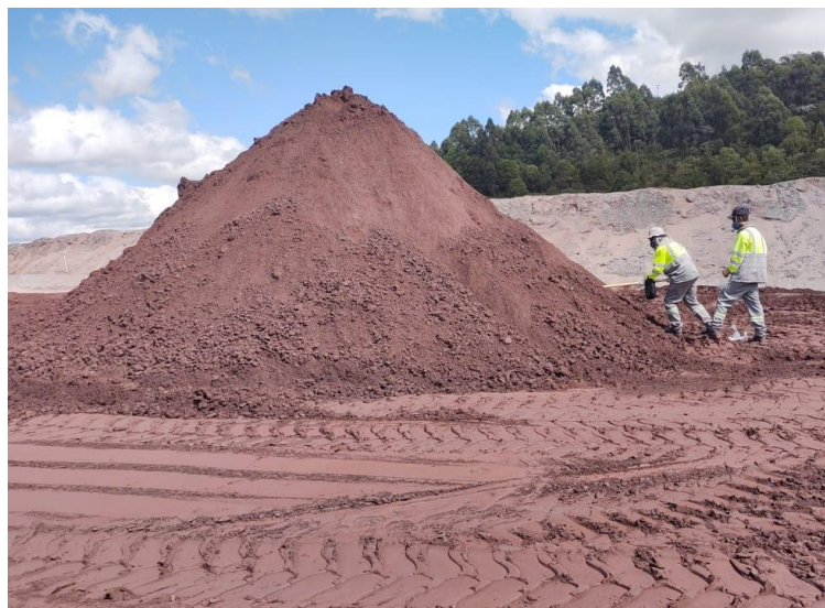
Figura 3.16 – Controle de umidade do rejeito
