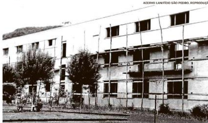
Projeto de Dario Granja Sant'Anna: a construção do prédio em meados de 1958, no centro de Galópolis
