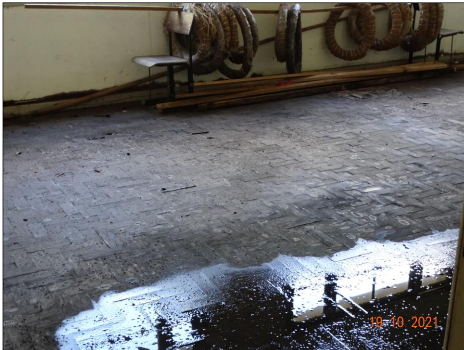
Figura 107 - Sala lateral ao saguão de entrada da Sede Social do Círculo Operário
