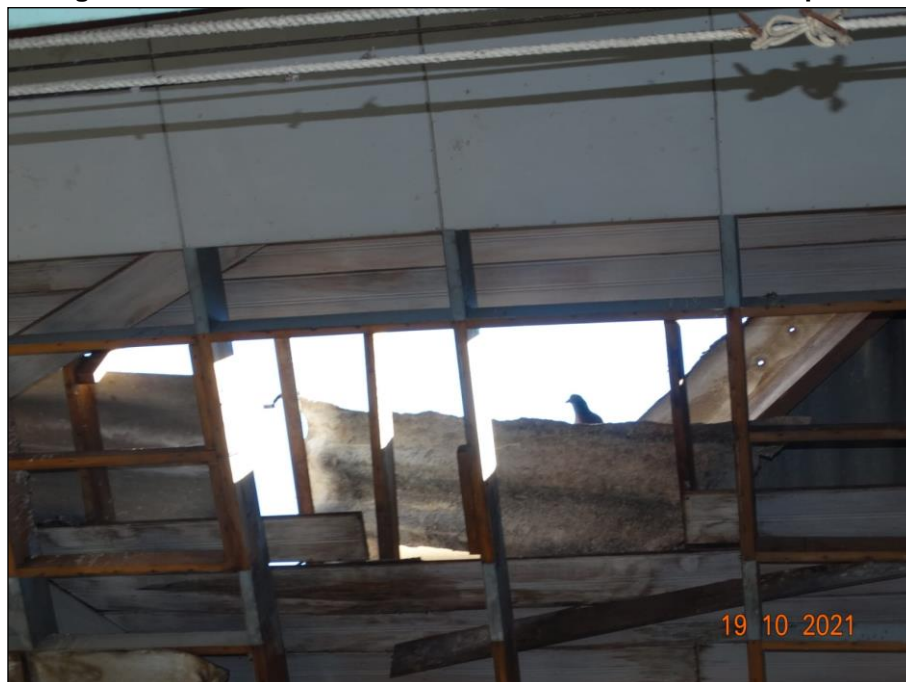
Figura 113 - Detalhe do forro e telhado danificados sobre o palco
