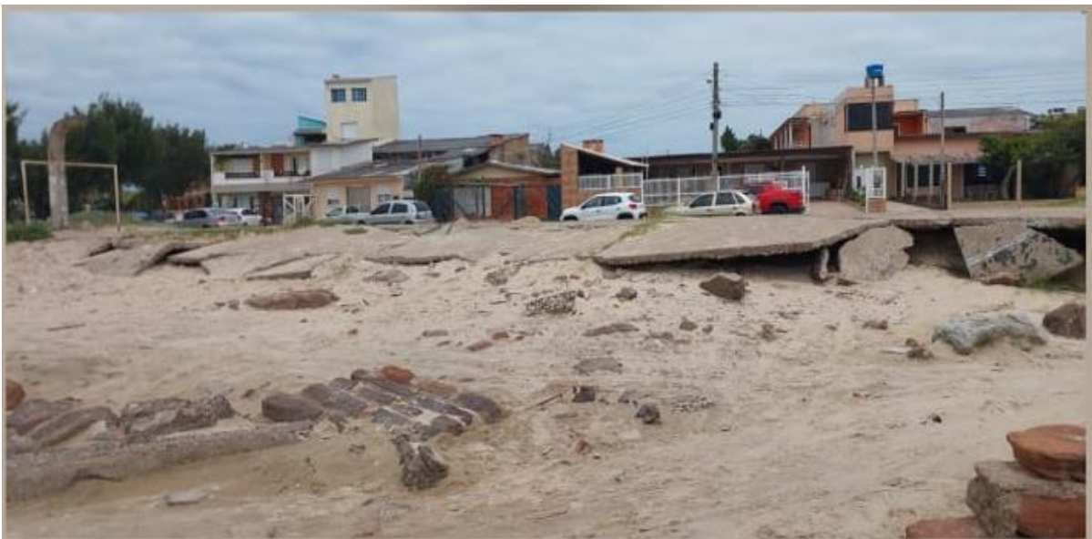
Figura 22 – Quadra de esportes da “Praça dos Botos” danificada por sucessivas ressacas marinhas.
