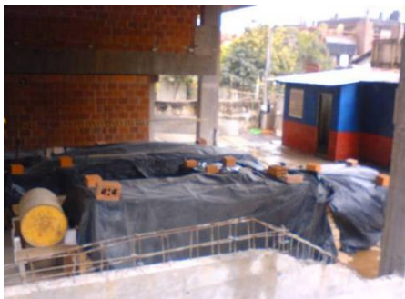
Figura 23: armazenagem de blocos no pavimento térreo
