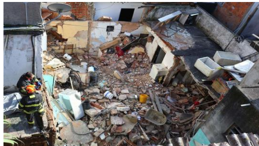
Figura 1 - Explosão por vazamento de gás deixa 1 morto
