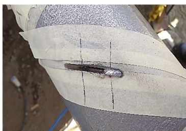
Figura 3.4.2 - Aspecto geral da trinca [Autor, 2022].
