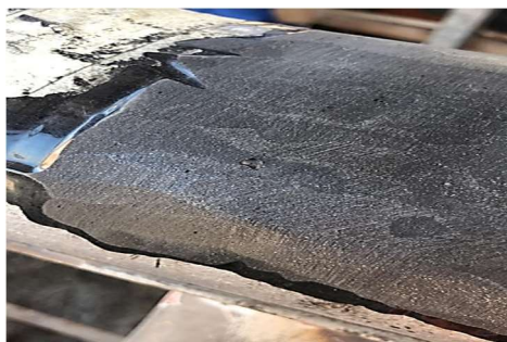
Figura 4.3.5 – Aspecto do reparo pós falha [Autor, 2022].
