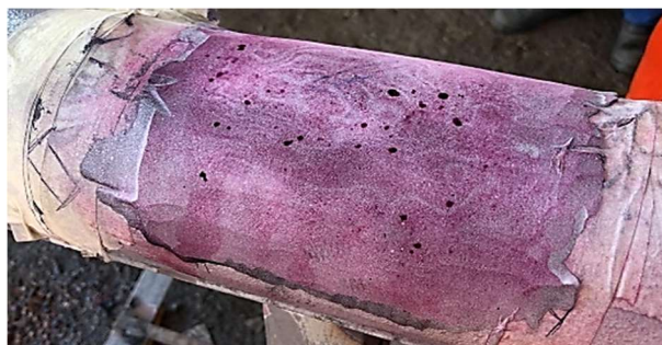
Figura 4.3.6 - Aspecto do reparo pós ensaio de líquidos penetrantes [Autor, 2022].
