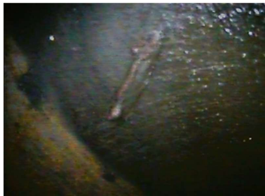
Figura 4.3.8 - Aspecto da trinca na face interna do substrato metálico [Autor, 2022].
