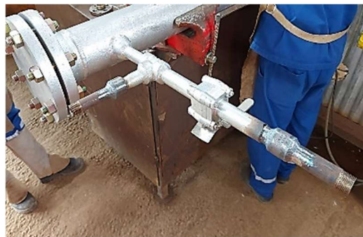
Figura 3.2.2 (f) - Conexões completamente instaladas [Autor, 2022].
