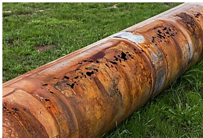
Figura 1.1.4 - Exemplo de corrosão severa [Environews Nigéria, 2022].
