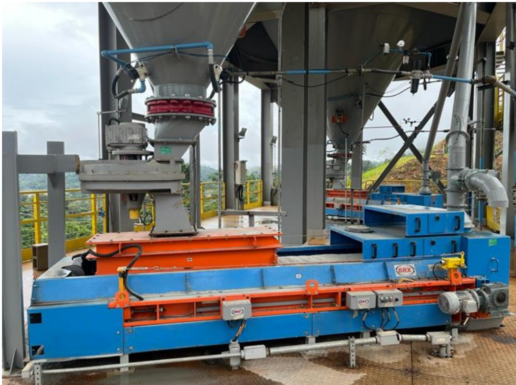
Figura 12 - Balança para dosagem na saída do silo de cimento.
