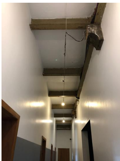
Figura 33 - Iluminação do Corredor/Módulo D
