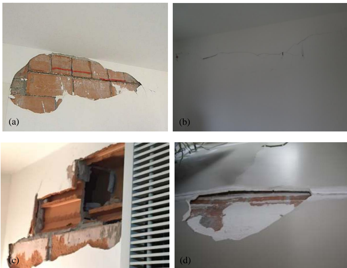
Figura 4 – Exemplos de manifestações patológicas em alvenarias de vedação devido às deformações da estrutura ao longo dos anos: (a) e (b) compressão da parede devido ao deslocamento da estrutura, (c) uso inadequado de blocos com furos na vertical e (d) tensões de compressão no revestimento
