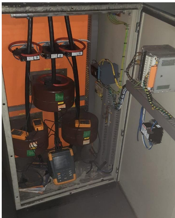
Figura 26. Analisador de qualidade de energia instalado para medição.
