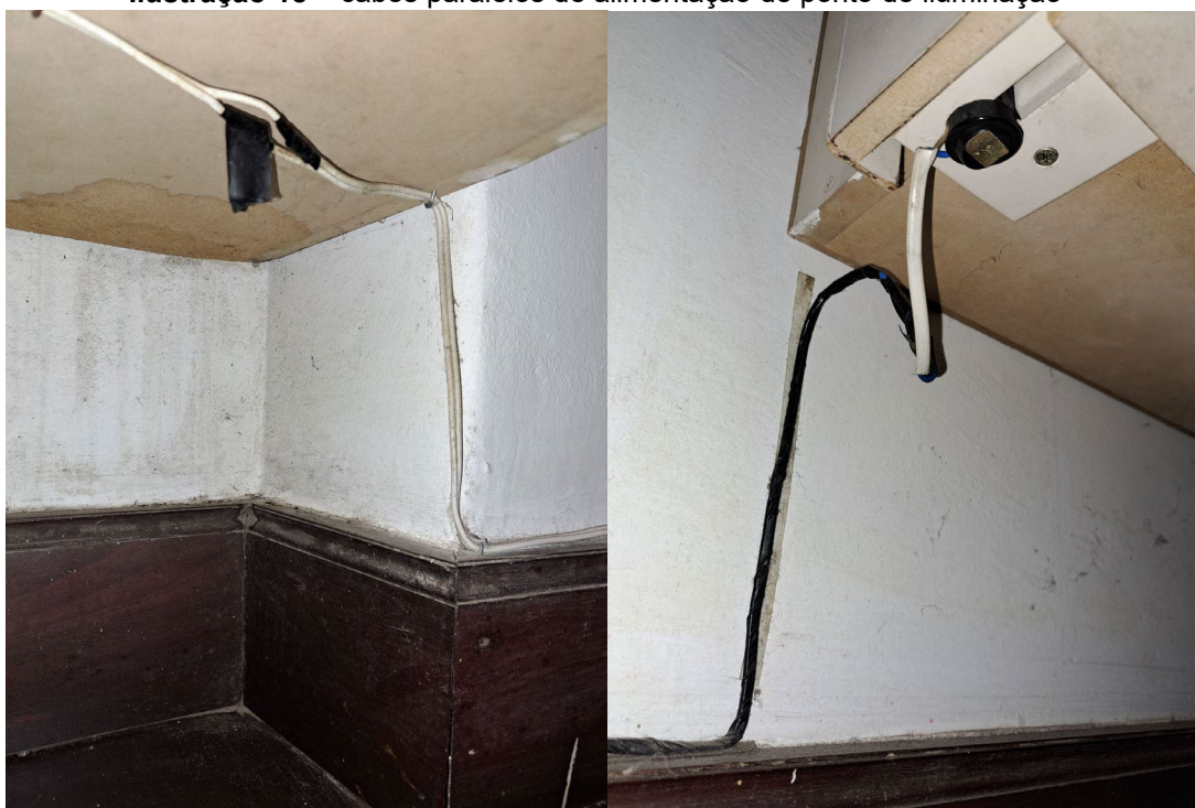
Ilustração 18 – cabos paralelos de alimentação de ponto de iluminação
