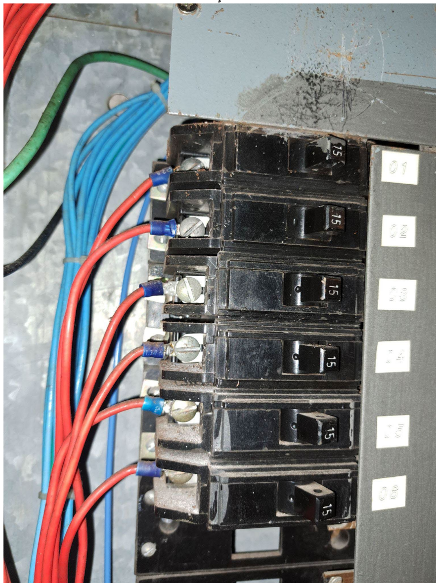
Ilustração 39 – Disjuntores de circuitos de iluminação do pavimento superior do Solar Lopo Gonçalves
