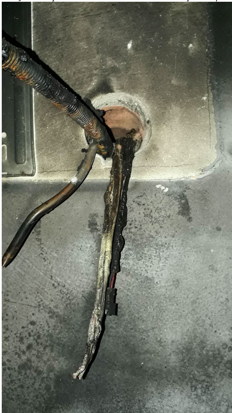
Ilustração 8 – Ação do incêndio nas linhas de alimentação do aparelho
