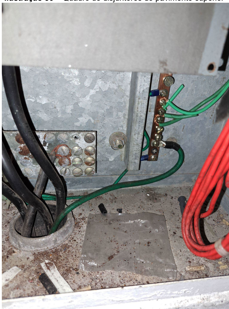
Ilustração 30 – Quadro de disjuntores do pavimento superior
