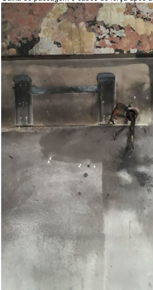
Ilustração 7 – Caixa de passagem e cabos de força após ação do incêndio
