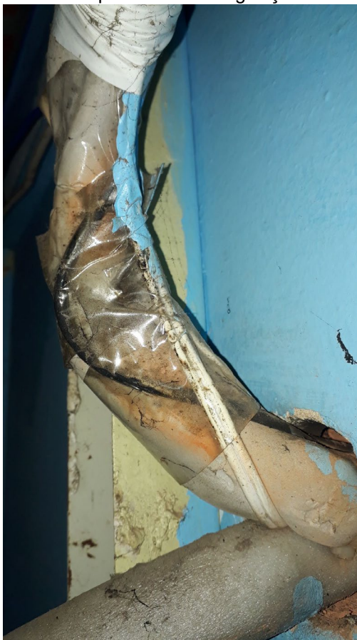
Ilustração 4 – Uso de cabo paralelo na energização do condicionador de ar.
