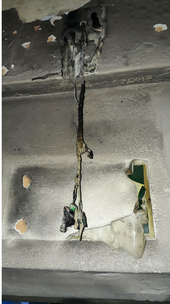
Ilustração 5 – Placa de balizamento derretida após incêndio
