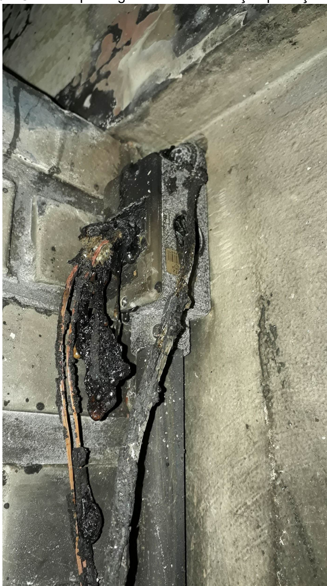
Ilustração 6 – Caixa de passagem e cabos de força após ação do incêndio
