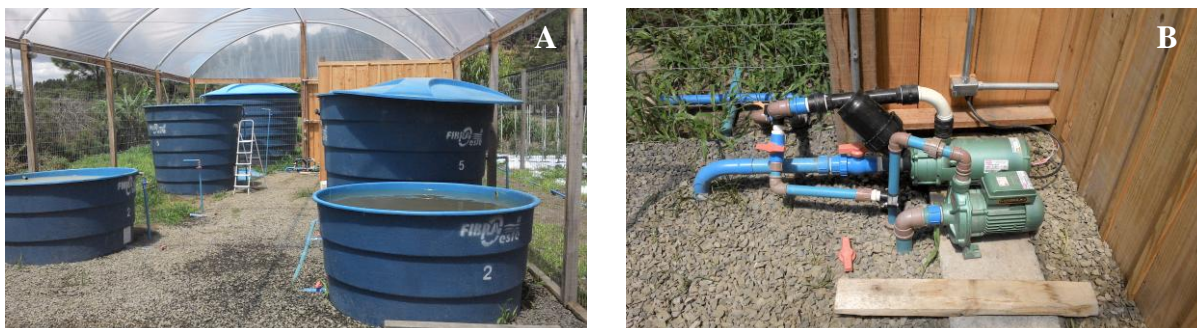
Figura 4. Área de diluição. A: Caixas d'água para diluição, B: Bombas Thebe, DE 1,5 E 1 c.v. Foto do autor
