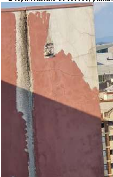
Figura 14 – Deslocamento do reboco, pintura e fissuras
