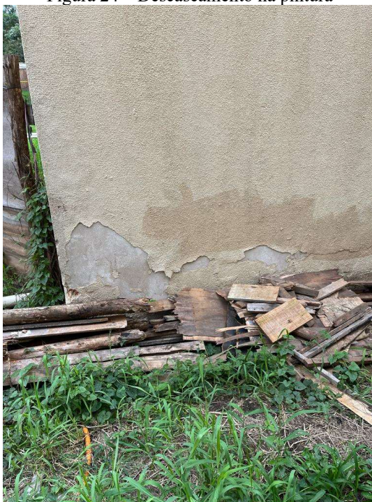
Figura 24 – Descascamento na pintura
