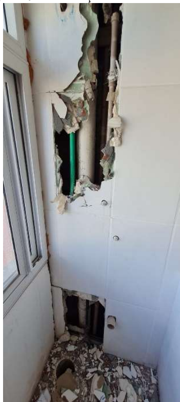
Figura 29 – Infiltração na rede hidráulica
