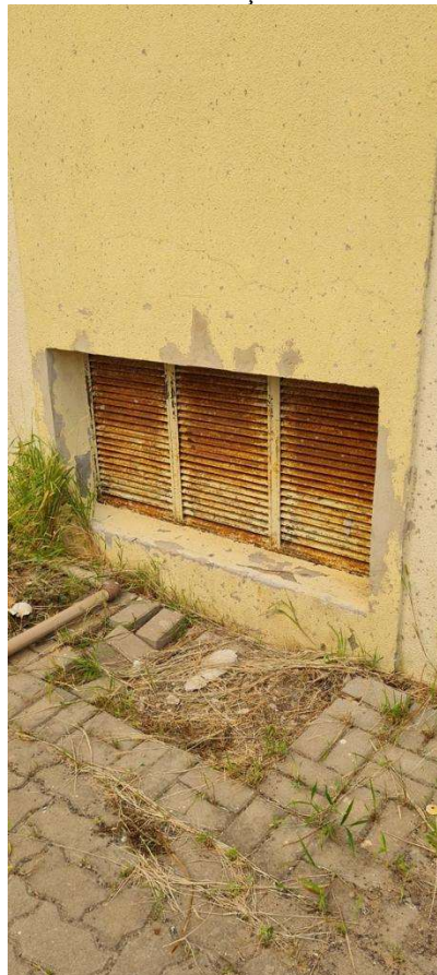
Figura 16 – Manchas de oxidação de elementos metálicos
