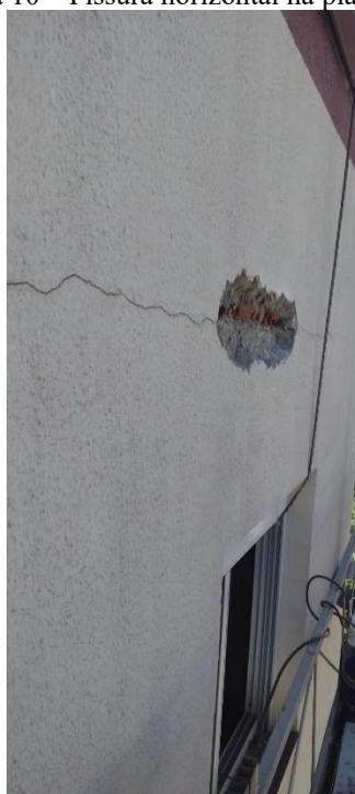
Figura 10 – Fissura horizontal na platibanda
