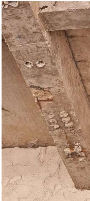
Figura 27 – Corrosão de armadura na viga
