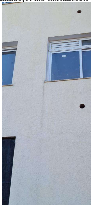
Figura 33 – Infiltração nas extremidades da pingadeira
