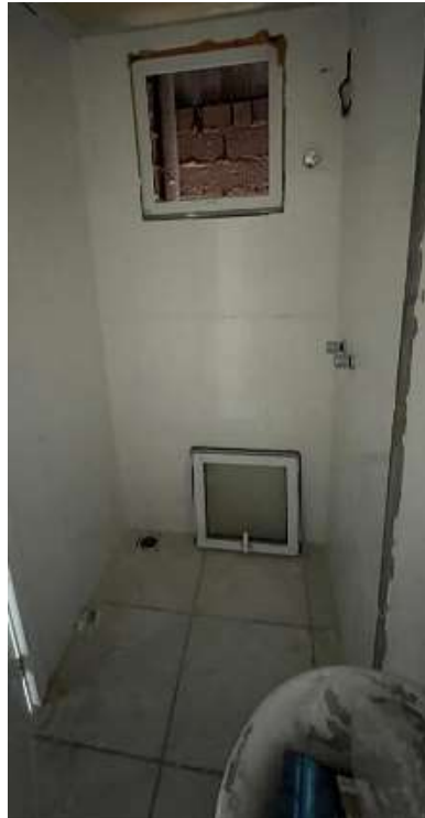
Figura 19 – Revestimento cerâmico no banheiro
