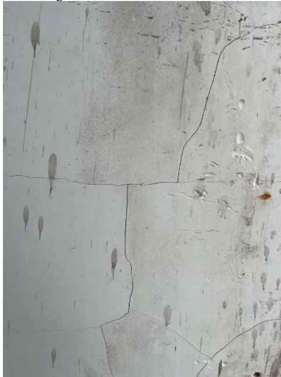
Figura 21 – Fissuras e descolamentos
