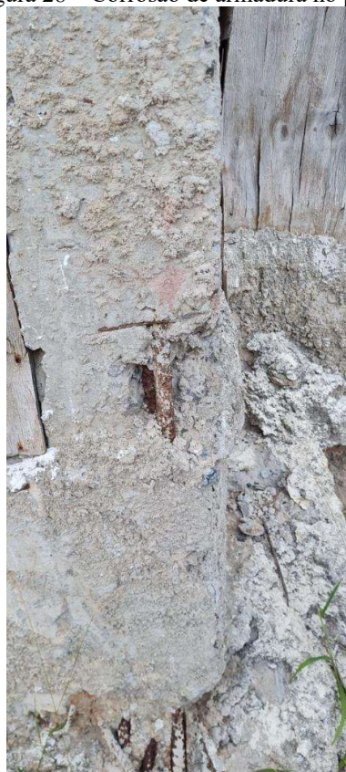
Figura 28 – Corrosão de armadura no pilar
