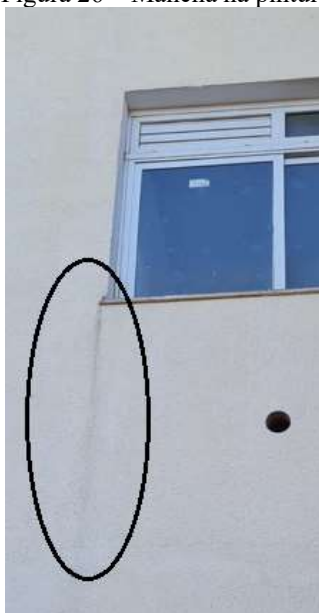
Figura 26 – Mancha na pintura
