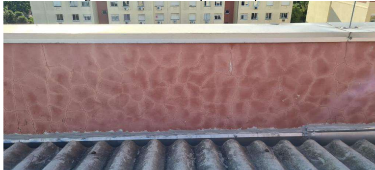
Figura 15 – Fissuras mapeadas na platibanda
