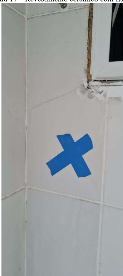
Figura 17 – Revestimento cerâmico com fissuras
