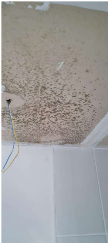
Figura 23 – Gesso acartonado sem a camada de proteção
