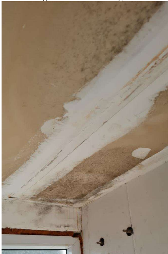
Figura 22 – Umidade no gesso
