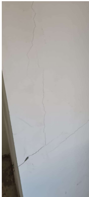
Figura 20 – Fissura em revestimento de gesso
