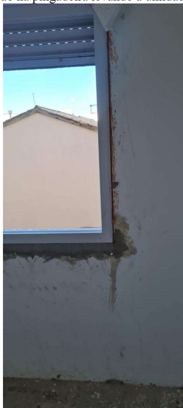
Figura 32 – Infiltração na pingadeira levando a umidade no ambiente interno
