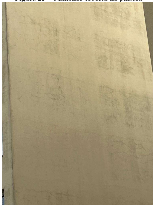
Figura 25 – Manchas escuras na pintura
