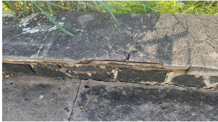
Figura 4- Rachadura no Reservatório
