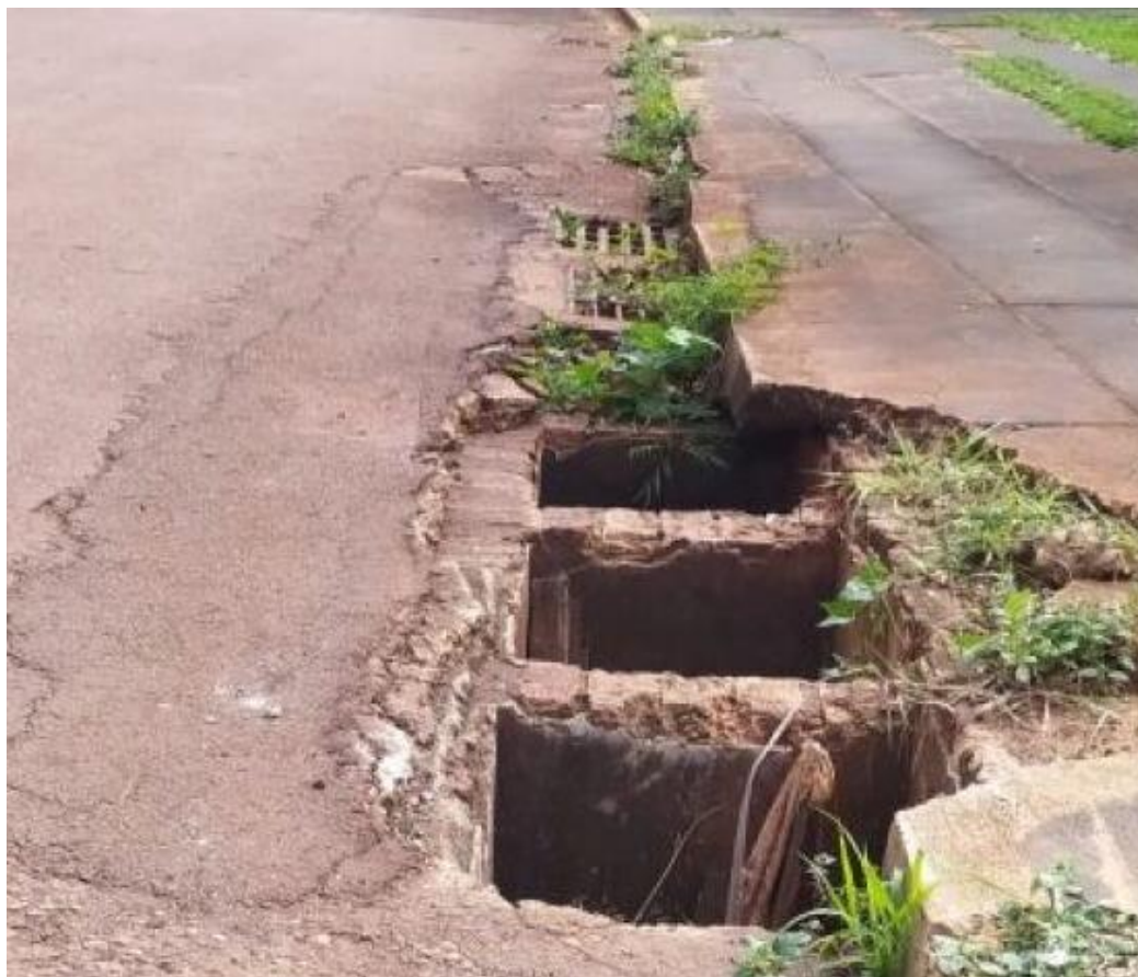
Figura 1 - Bocas de lobo sem grelha
