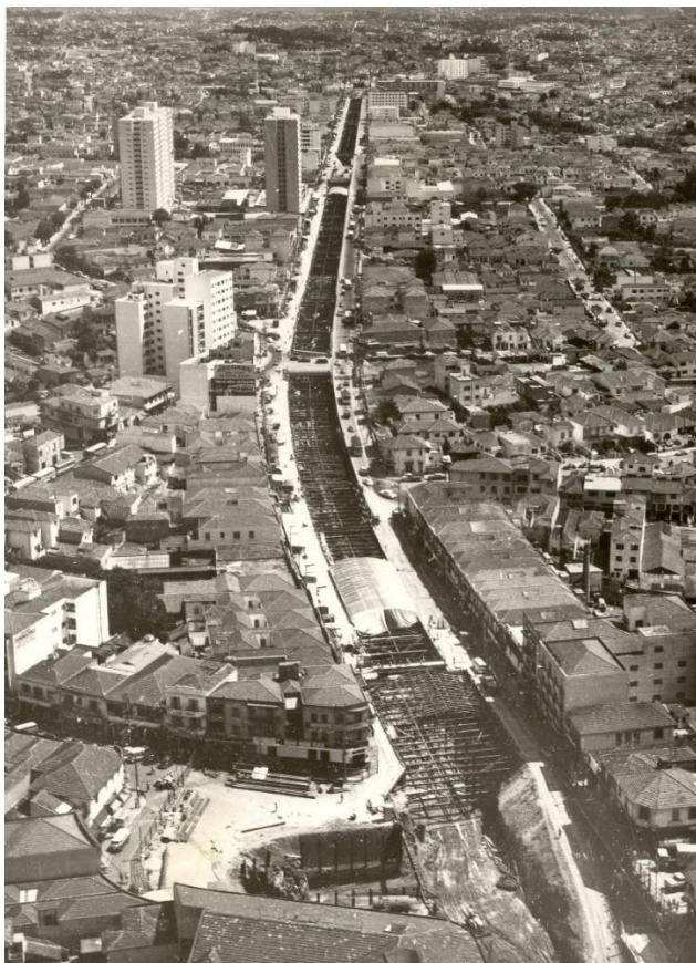
Figura 63 - Foto da construção da Linha 1 - Azul nos anos 1970, vista em direção ao Sul, com escavação da Estação Praça da Árvore em primeiro plano
