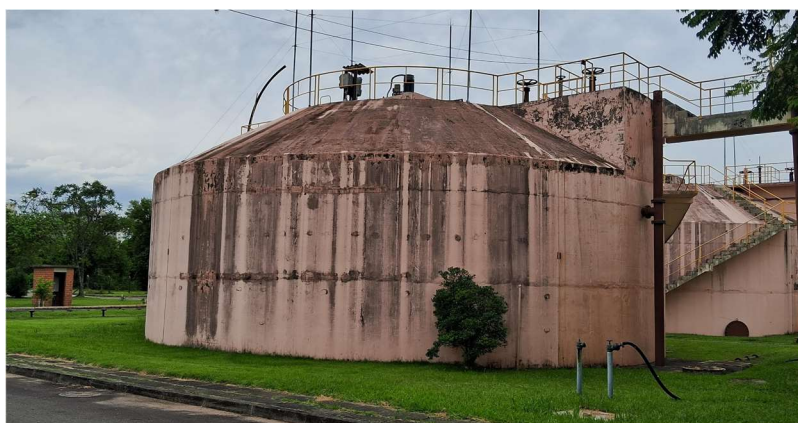
Figura 13 - Digestor anaeróbio da ETE São João/Navegantes
