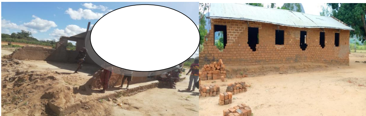
Figura 11: Salas de aulas destruídas pelo ciclone Gombe e Ana em 2022 em Nampula
