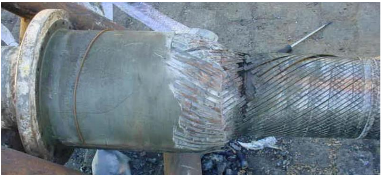
Figura 14 – Fios rompidos por fadiga na região do conector.
