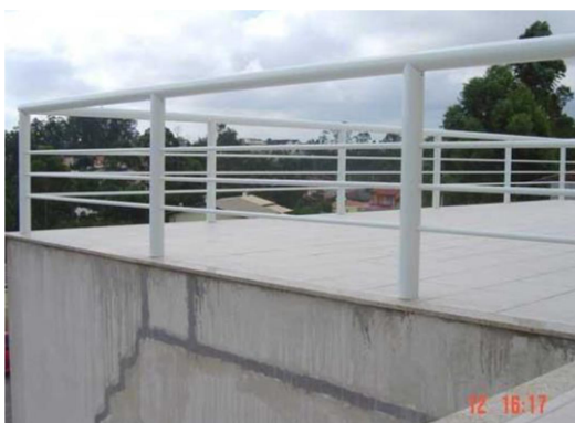
Figura 9. Detalhe de fissura por movimentação térmica.
