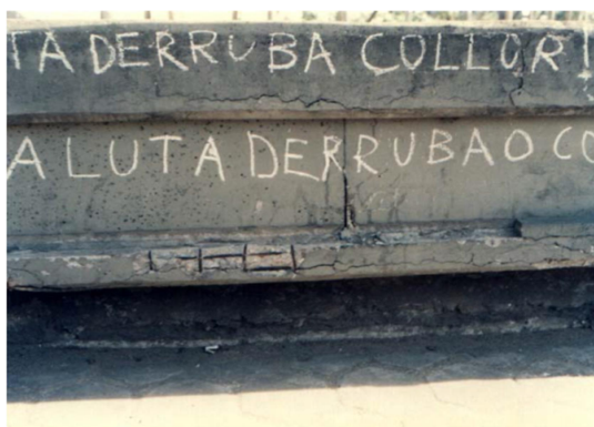
Figura 10. Detalhe de fissura por corrosão da armadura.
