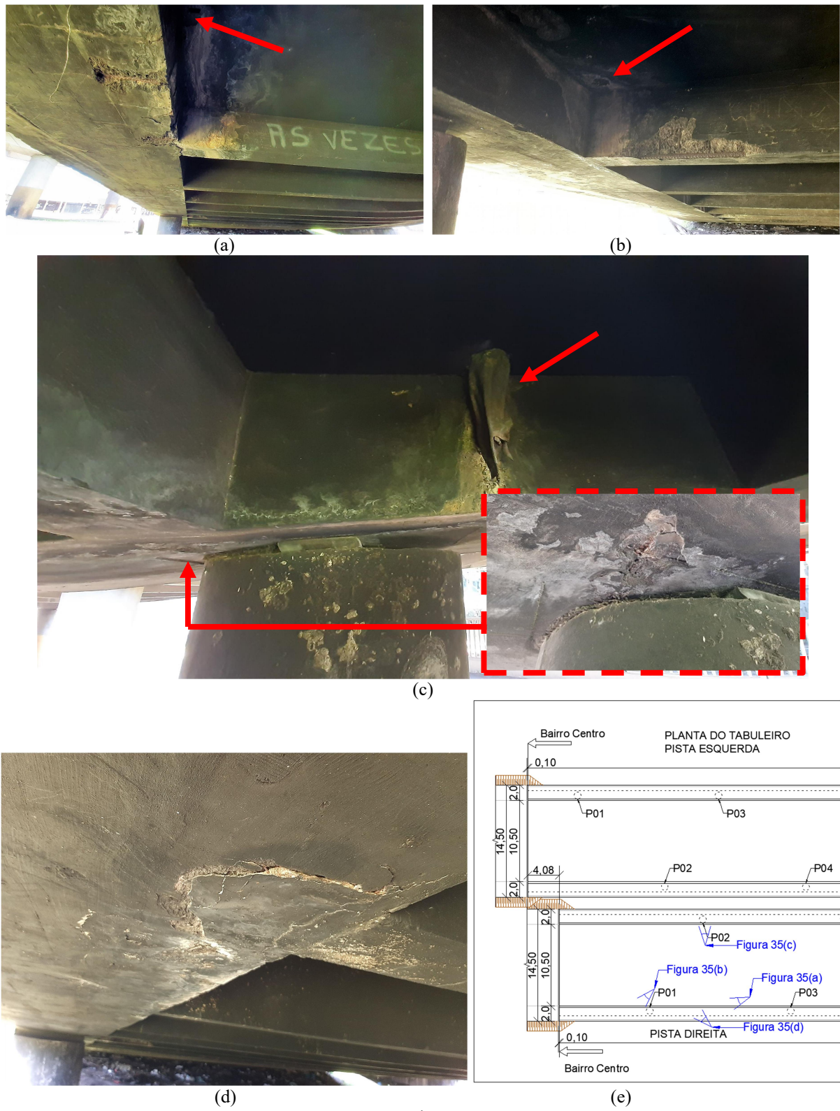
Figura 35. Drenos quebrados na viga principal externa do Viaduto pista da direita (a, b, d). Dreno queimado na viga principal interna (c) e Mapeamento das fotos (e).
