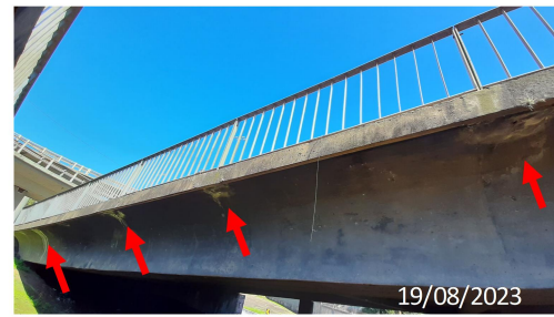
Figura 18 - Todas vigas principais internas dos viadutos região onde foram chumbadas as hastes de sustentação do guarda corpo, apresentam fissuras, corrosão da armadura, eflorescências, desagregação do concreto, falta de cobrimento
