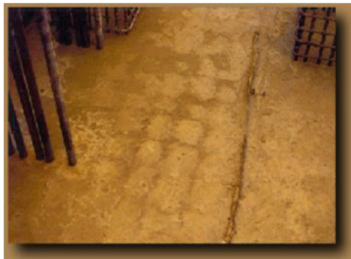
Figura 5. Detalhe de fissura ao longo da armadura
