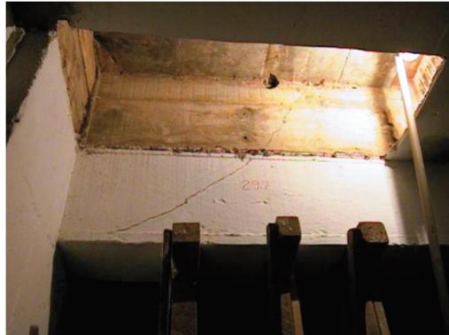
Figura 13. Detalhe de fissuras por cisalhamento.
