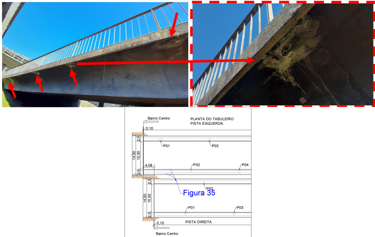
Figura 36. Fotos na região da fixação da viga principal interna e a posição das fotos mapeadas.
