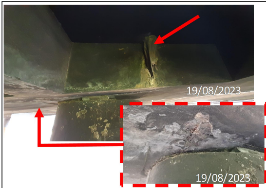
Figura 17 - Dreno queimado na viga principal interna pista direita. manchas de umidade, eflorescências, em alguns casos há formação de biofilme, lascamento do concreto, desagregação e perda de cobrimento e oxidação do aço
