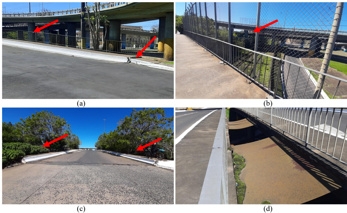
Figura 45. Fotos dos defeitos nos pavimentos. Detalhe do guarda-corpo amassado e degrau no passeio (a); abertura na grade (b); vegetação no passeio (c) e chapas de aço (d); Mapeamento das fotos (e).
