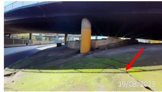
Figura 26 - Fissuras no talude Encontro 01
