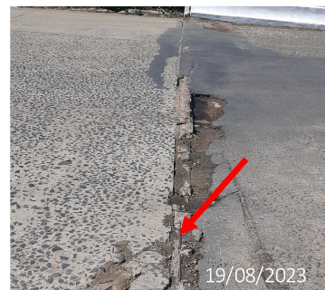
Figura 24 - Armaduras expostas e falta de cobrimento no topo junto à região da junta de dilatação
