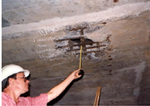
Figura 20. Falha de concretagem, Viaduto Imperatriz Leopoldina
