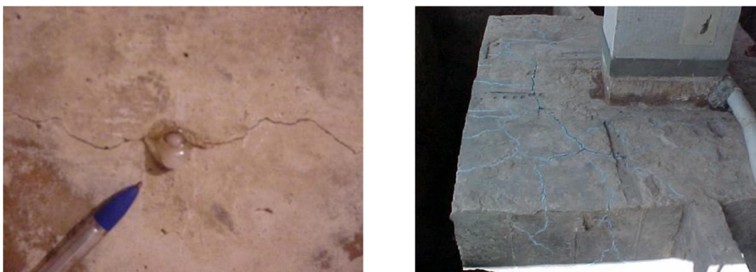
Figura 12. Detalhe de fissuras por reação álcali-agregado.
