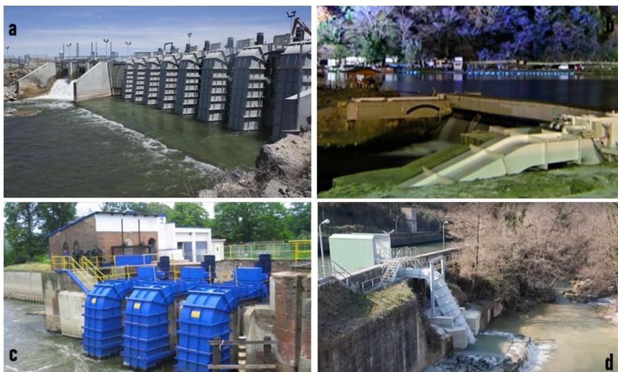
Figura 3. Plantas de sifões operando em Idaho (a), Kyoto (b), Olawa (c) e Nera (d).
