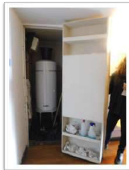
Figura 3-65 e 3-66: Armário técnico da célula que armazena o boiler. Fonte: Arquivo pessoal.
