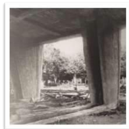
Figura 4-63: Vista frontal dos pilotis , mostrando o duto de passagem de canalizações. Fonte: FONDATION LE CORBUSIER
