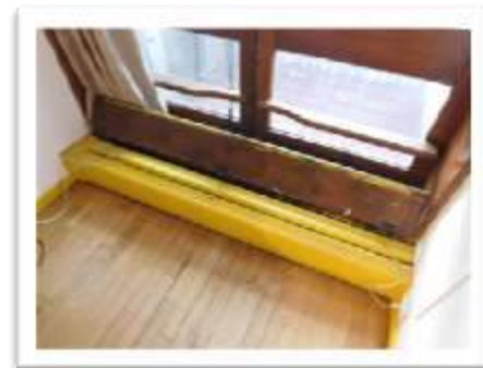
Figura 4-170, 4-171: Detalhe do sistema de aquecimento abaixo do banco de carvalho. Fonte: Arquivo Pessoal.
