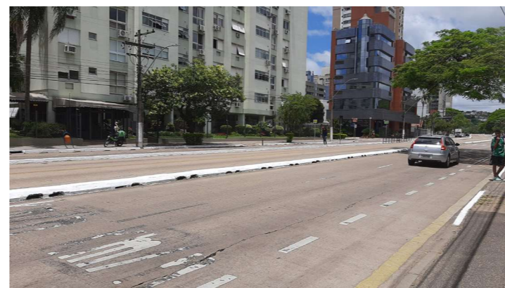
Pedestre caminhando em meio fio/barreira do corredor de ônibus por falta de refúgios e travessias práticas
