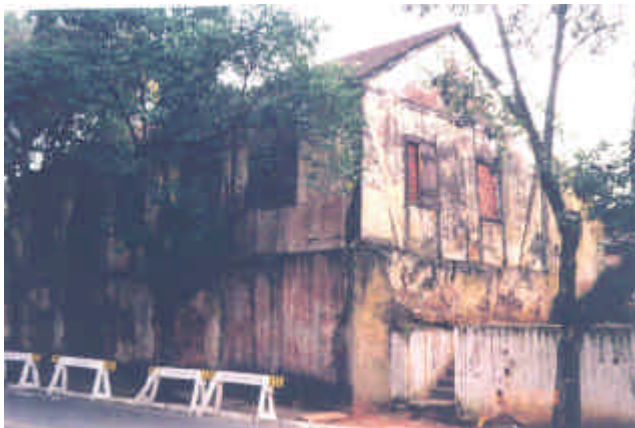
FIGURA 19 A – CASA ODY ANTES DA RESTAURAÇÃO Rua General Daltro Filho, 910 – NH – RS Propriedade de herdeiros Sr. Oscar Ody Fonte: foto da autora. Data: julho 1997.
