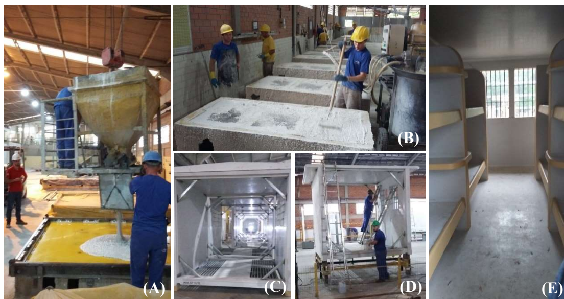
Figura 1: Etapas de execução de CRF's para células prisionais: (A) Execução de mobiliário de GRC através de método autoadensável; (B) técnica spray-up com lançamento de camas sucessivas e compactação por rolo também utilizada para fabricação da mobília; (C) galeria prisional feita integralmente com CRF; (D) execução de acabamentos; (E) aspecto final com monobloco estrutural da galeria em CRF e mobiliário em GRC.
