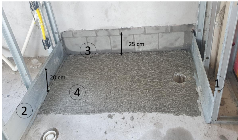
Figura 4 –Item1: montante para estrutura de gesso acartonado, item 2: rodapé metálico, item 3: canaleta do rodapé em alvenaria e item 4: camada de aderência em piso de concreto
