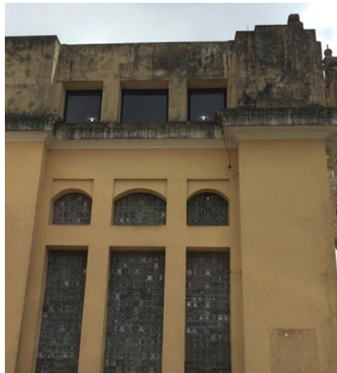
Figura 55 – Região no topo da fachada não apresenta detalhes construtivos para proteger o topo da exposição à chuva dirigida, enquanto a presença de elemento saliente protege a porção do revestimento imediatamente abaixo
