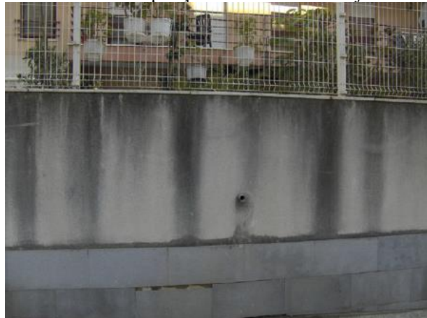
Figura 9 – Detalhe de deposição não uniforme de sujeira em muro
