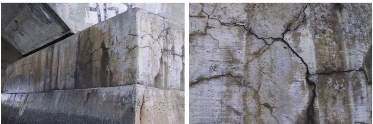
Figura 11 - Fissuras provenientes da reação álcali-agregado na fundação da ponte Paulo Guerra
