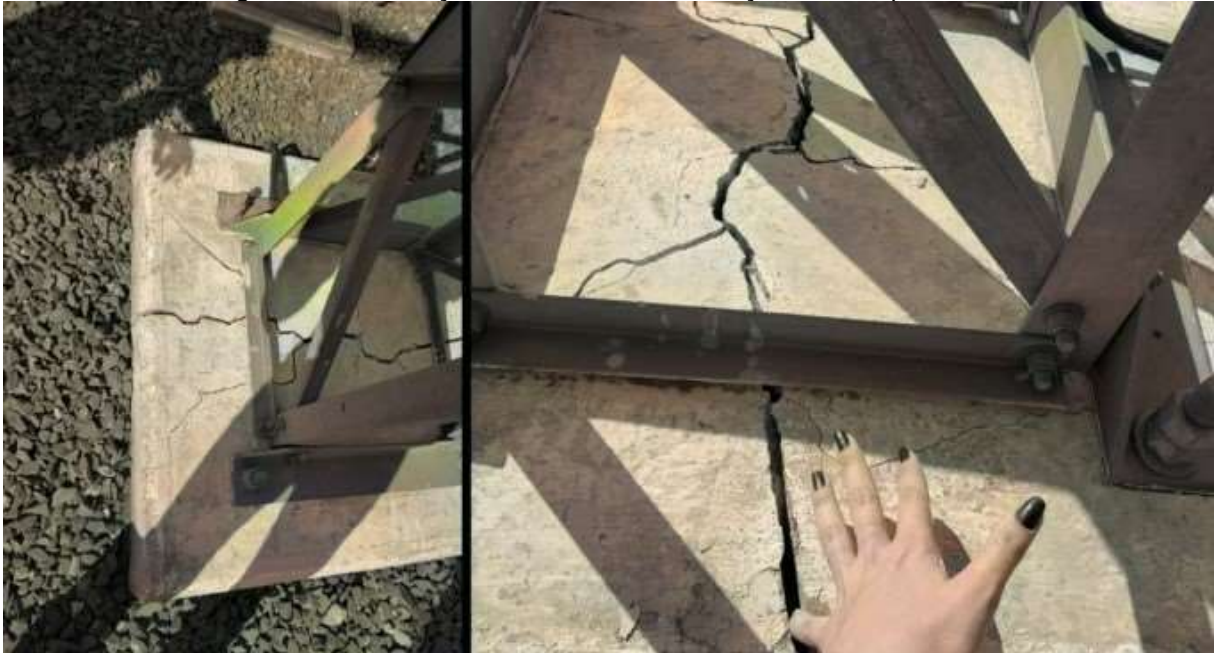
Figura 10 - Fissuração de um bloco de fundação afetado pela RAA
