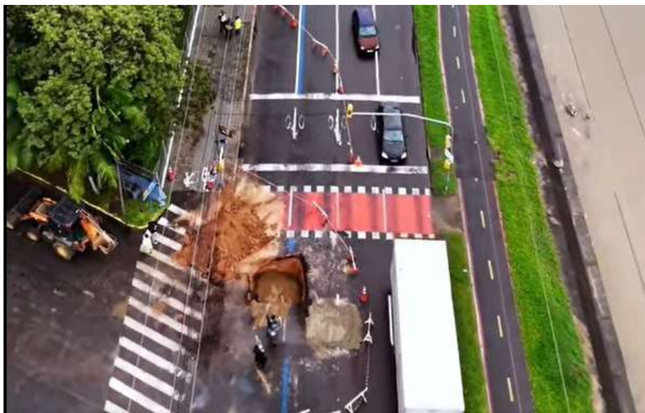
Figura 47: Ruptura do pavimento asfáltico sobre trecho canalizado do Arroio Moinho, próximo à sua foz no Arroio Dilúvio, na Avenida Ipiranga, no dia 26/05/2024. Além do dano ambiental, esses eventos causam transtornos econômicos para reparo da avenida. Fonte da fotografia: RBS (2024).
