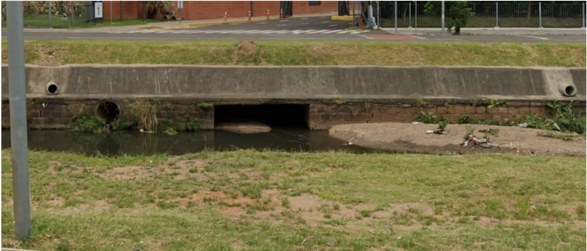
Figura 23: Foz do Arroio Moinho no Arroio Dilúvio. Nota-se a presença de bancos de areia no Arroio Moinho e no Arroio Dilúvio decorrentes do processo de assoreamento ocasionado pela redução da velocidade da água e da competência do canal de carregar determinados tipos de sedimentos. Observa-se a presença de lixo e vegetação nos bancos de areia. Fonte: do autor, out., 2024.
