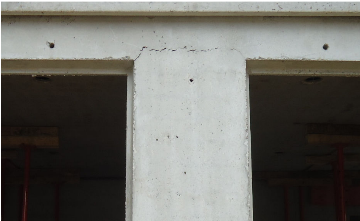
Figura 19: fissura devido ao choque mecânico de uma parede de concreto
