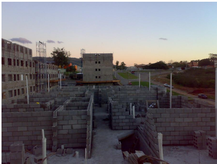
Figura 9: assentamento de oito fiadas de blocos sem o uso de andaimes e castelinhos
