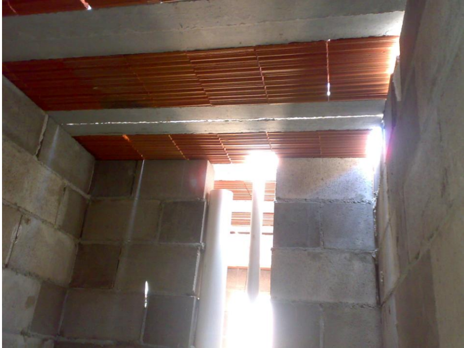
Figura 15: interferência da alvenaria com instalações hidrossanitárias.
