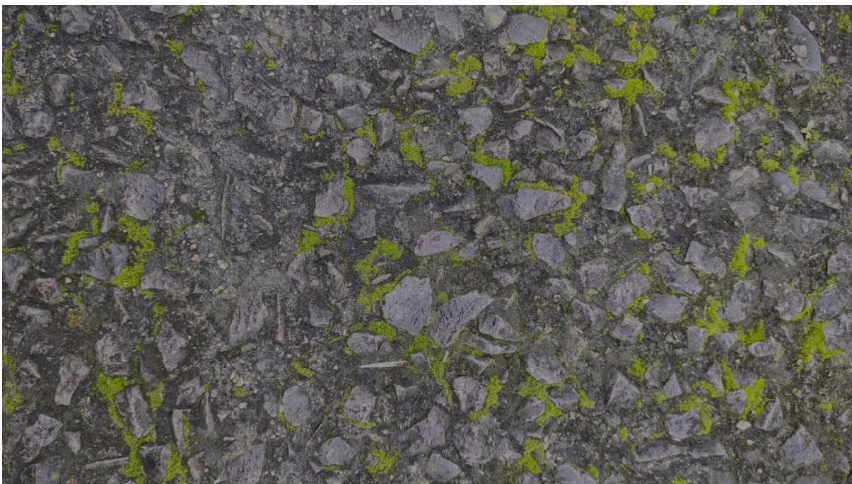
Figura 7 - Mofo no concreto. Morro Santana.
