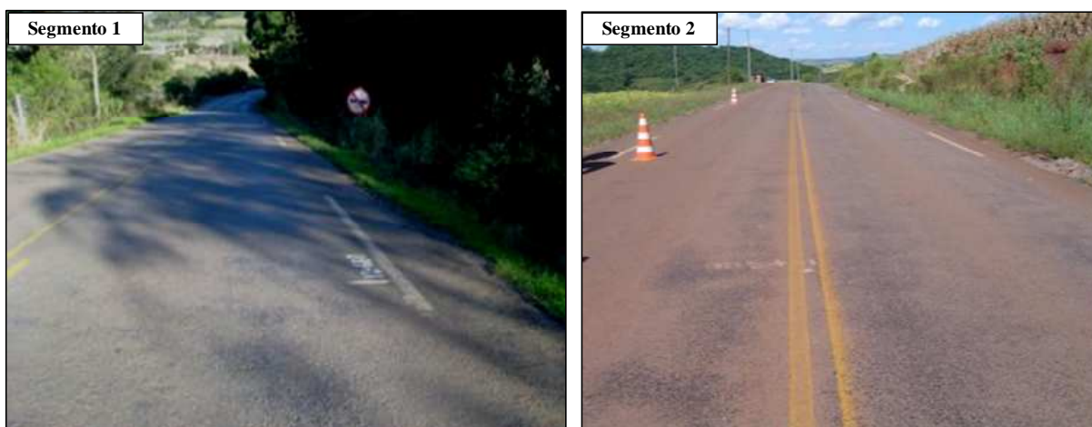
Figura 3.3: Situação do pavimento em 2007
