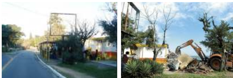
Figs. 3.66 e 3.67: O bar clandestino Timbuka, na Vila Assunção, havia invadido até o passeio. Foi demolido somente por ordem judicial, em 10 abr. 2009.
