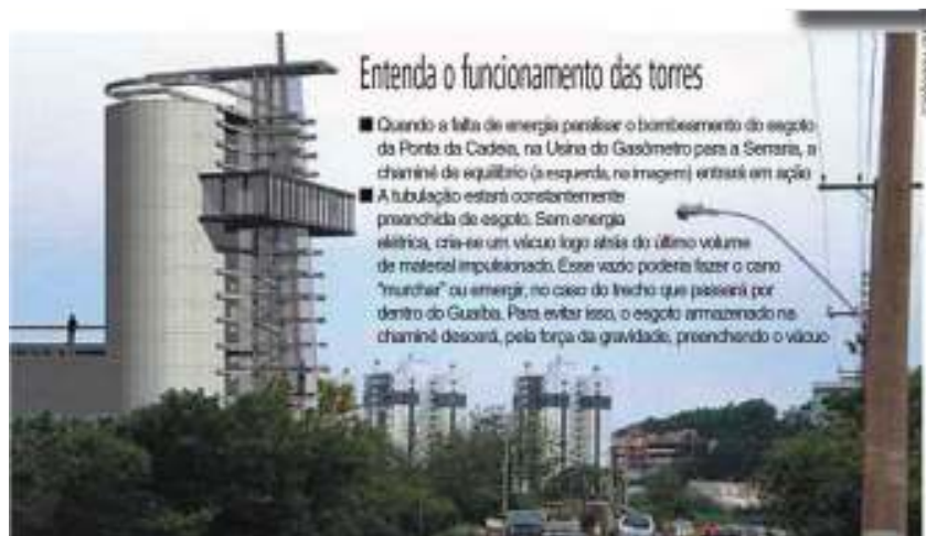
Fig. 3.84: Chaminé de equilíbrio, que terá observatório panorâmico, já está em obras na Av. Diário de Notícias.
