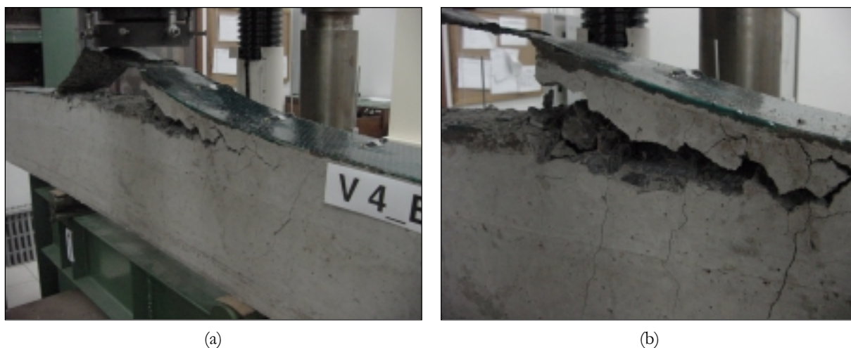
FIGURA 5-5 — Detalhe do modo de ruptura das vigas reforçadas com uma camada de manta
