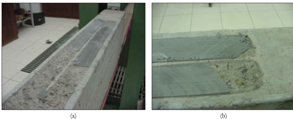
FIGURA 5-3 — Detalhe do descolamento na interface adesivo/compósito
