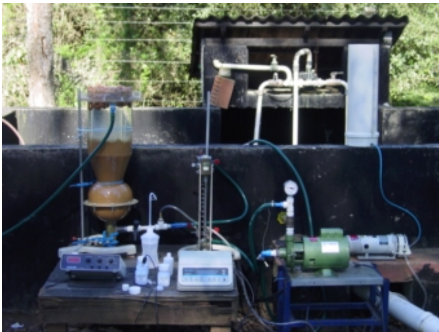
FIGURA 47 – Unidade REFA instalada na estação de tratamento de efluentes de uma galvanoplastia.
