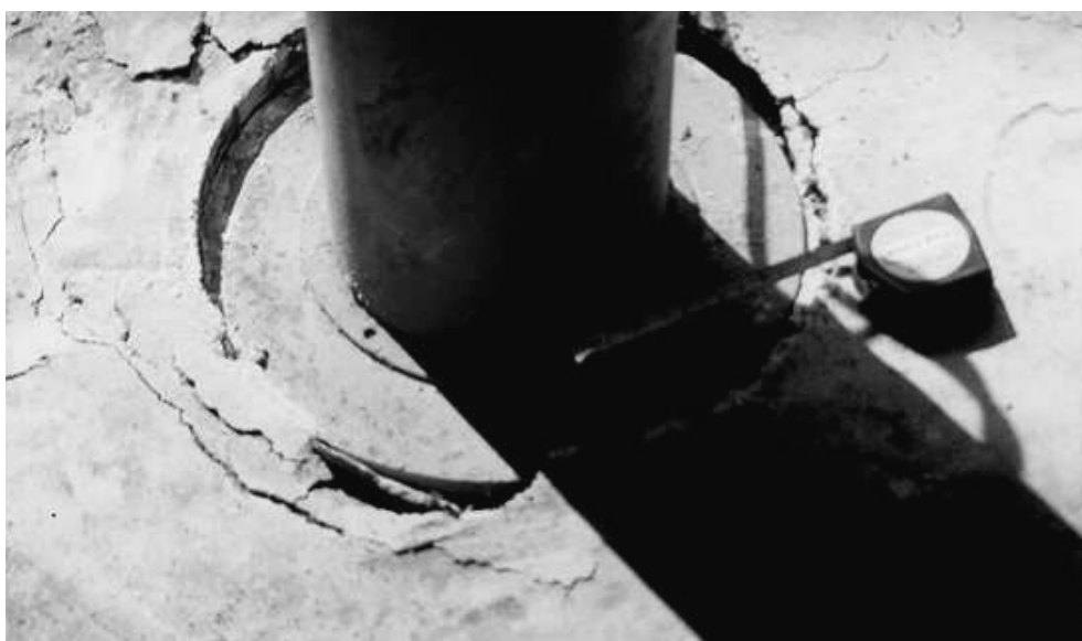
Figura 6.25 – Ruptura típica observada na superfície da camada cimentada em todos os ensaios de placa.
