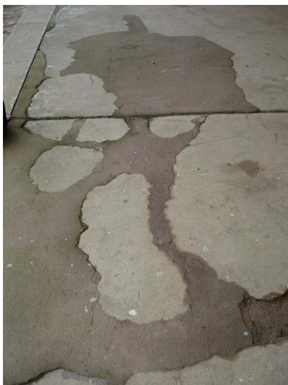
Figura 81: Registro de mancha produzida pela umidade no chão que inspira uma forma, Armazém A7 do Cais do Porto, Porto Alegre/RS, 2009.
