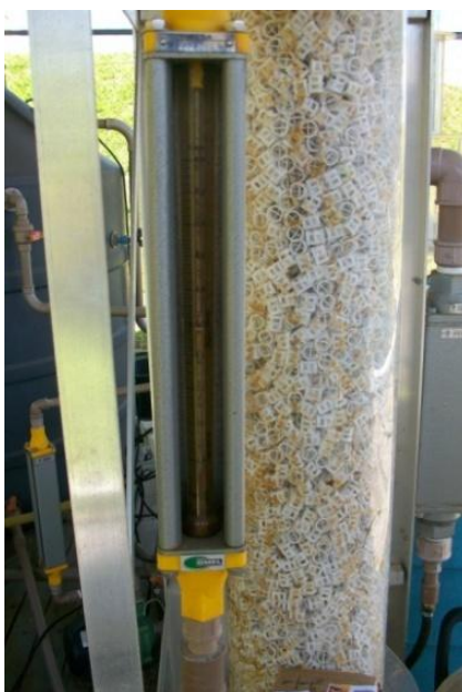
Figura 46. Torre de dessorção em funcionamento
